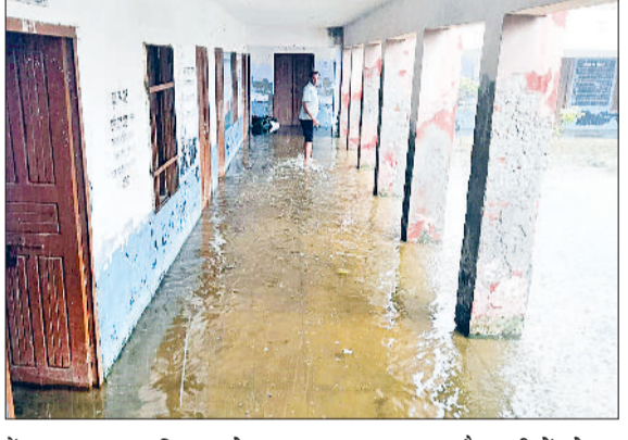
में आना-जाना मुश्किल हो गया है, बल्कि स्कूल के पास लगे बिजली के ट्रांसफार्मर से भी खतरा बढ़ गया है। ग्रामीणों को डर है कि कहीं कोई अग्रिय घटना न हो जाए।
